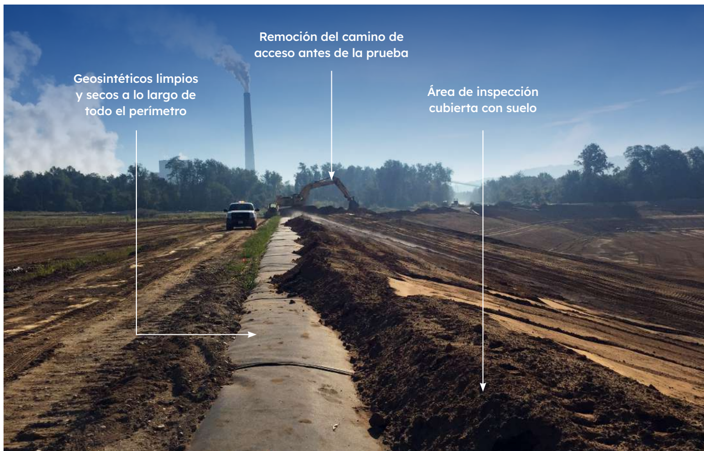
Figura 2: Brecha de aislamiento perimetral alrededor del área de inspección cubierta con suelo
